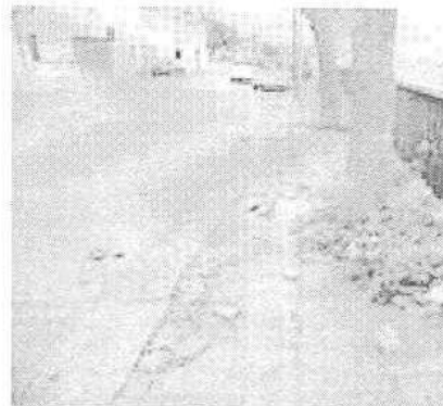
VIA COLAJANNI: marciapiede impraticabile. Un vero pericolo per i pedoni che transitano in quel tratto.
